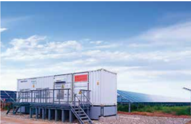
02 Proyecto Utility en la planta fotovoltaica de 300 MW en Rusia
