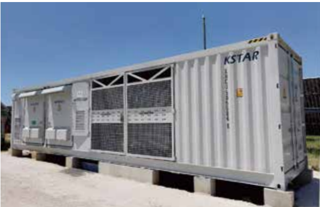
03 Proyecto Utility en la planta fotovoltaica de 10MW en España
