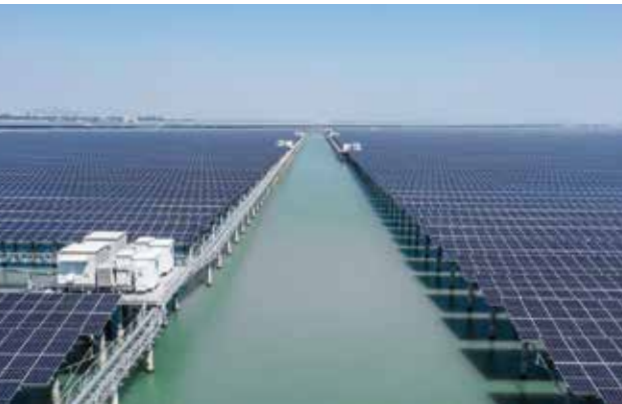
06 Proyecto Utility en la planta fotovoltaica de superficie acuática de 550MW en Zhejiang
