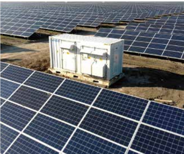
07 Proyecto Utility en la planta fotovoltaica de 200 MW en Ucrania
